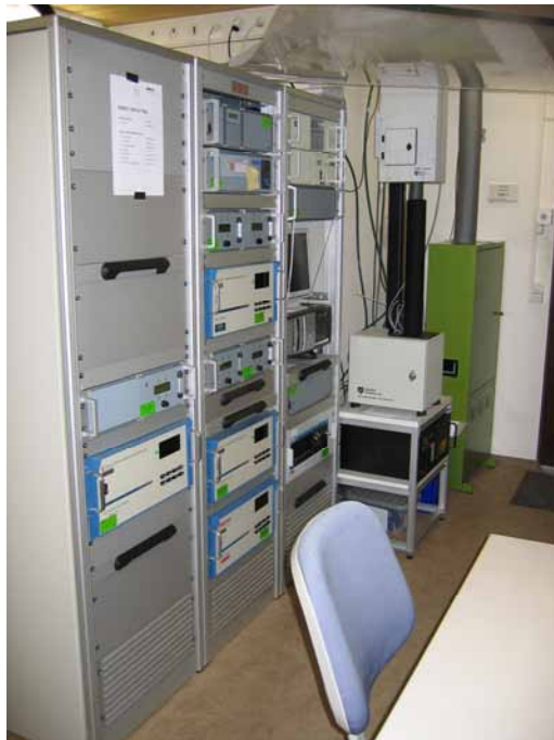
Abb. 2-47: Innenansicht einer NABEL-Station
