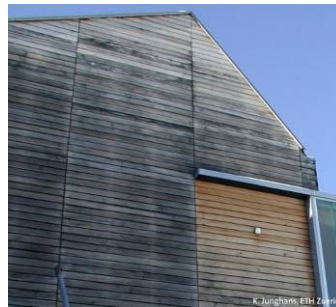
Abbildung 28 Vergraute, dem Regen ausgesetzt Fassade
