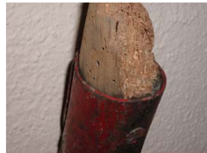
Abbildung 57 Schaden durch Nagekäfer an Geländerholm
