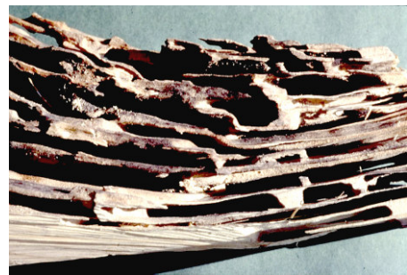
Abbildung 59 Durch Pilze und Ameisen zerstörtes Stück Holz
