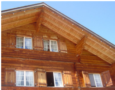
Abbildung 27 Braune Fassade unter Dach
