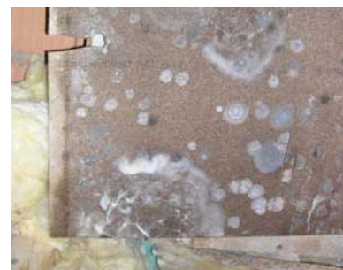
Abbildung 32 Schimmelpilze auf Spanplatte (Quelle: www.holzfragen.de )
