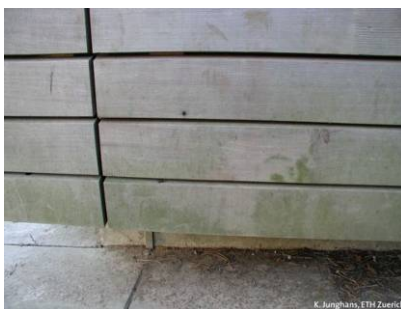
Abbildung 2.49 Besiedlung einer Holzfassade mit Algen (Spritzwasserbereich)
