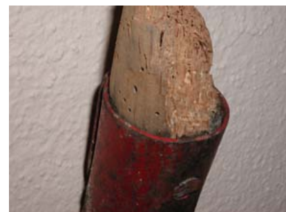
Abbildung 2.77 Schaden durch Nagekäfer an Geländerholm
