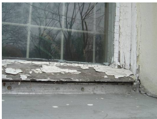
Abbildung 2.42 Abplatzen der Farbschicht an Fenster mangels Unterhalt
