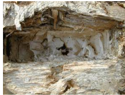
Abbildung 2.72 Myzel im Riegelanschluss eines Fachwerkbaus
