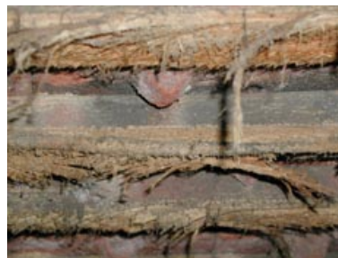
Abbildung 2.41 Mazeration (chemisch erwirkter Schaden) an Deckenbalken (Quelle: www.holzfragen.de)
