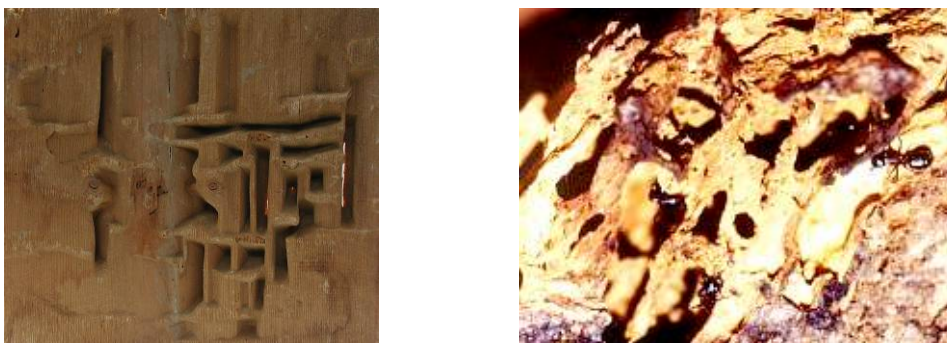
Abbildung 2.86 Schadbild und Befall durch Holzzerstörende Ameisen (Quelle rechts: www.pentol.ch )
