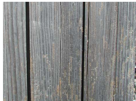
Abbildung 2.80 Wespenfrass kann die Oberflächen von Fassaden beschädigen
