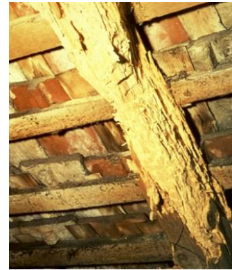
Abbildung 2.81 Schaden an Dachbalken durch Hausbockkäfer
