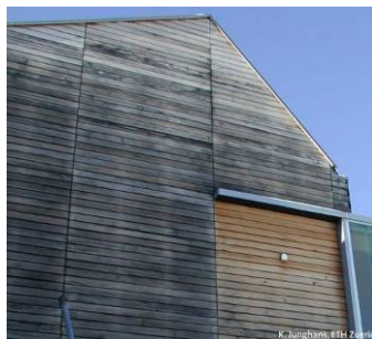
Abbildung 2.48 Vergraute, dem Regen ausgesetzt Fassade
