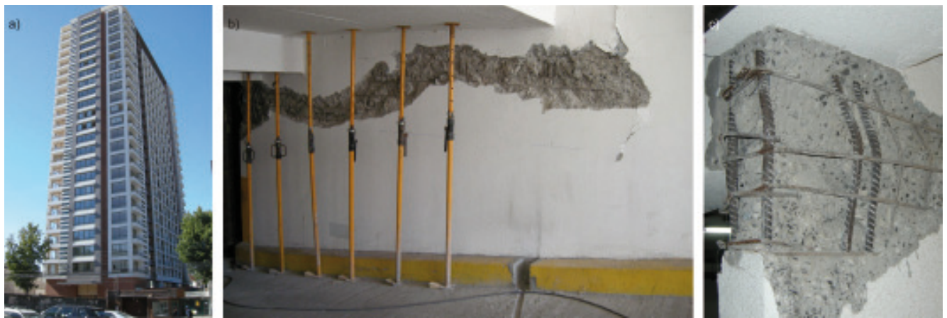
Bild 2. 24-stöckiges Stahlbetontragwandgebäude Castellon 152 in Concepción: Ansicht (a) und Biege-Druckversagen einer Stahlbetontragwand im ersten Untergeschoss (b und c).
