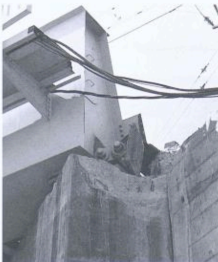
Bild 13. Aus der Verankerung gerissenes Horizontalkraftlager einer Eisenbahnbrücke
