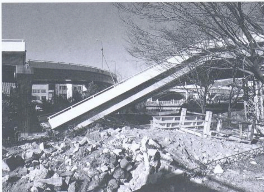
Bild 11. Absturz des Trägers einer Verbundbrücke
