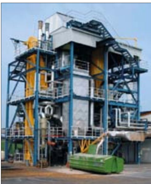
Das Biomassekraftwerk im österreichischen Güssing liefert das Produktgas für die PSI-Versuche.
