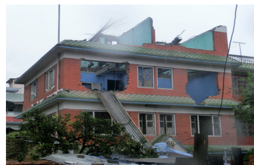
Zerstörtes Gebäude in Kathmandu (August 2015).
