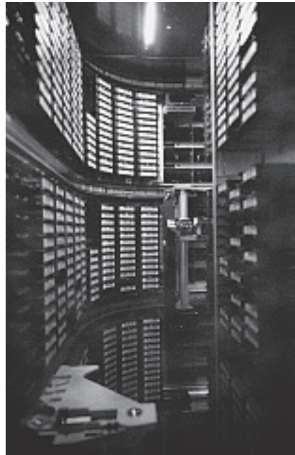
Data Centre ETH Zurich
