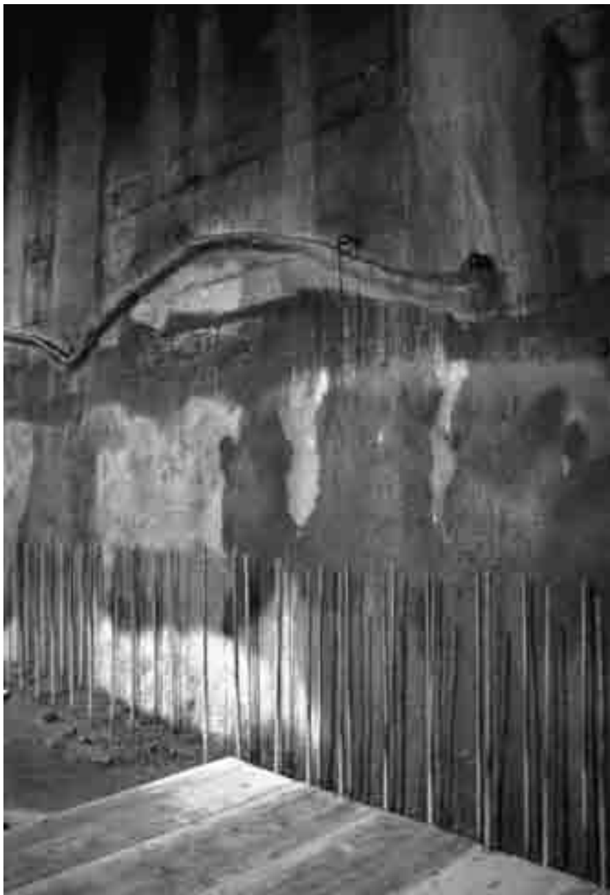
Abb. 21: Wassereintritt in der Maschinenkaverne (AKS, Nachlass Ribaux, 322.6).
