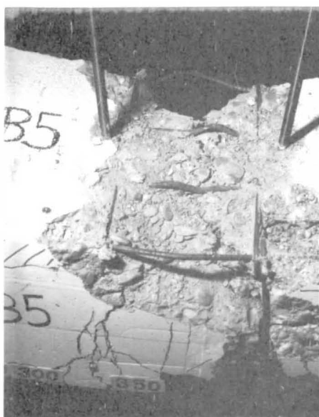
Ober- und Rückseite, x = 4.0 m Bereich der grössten Beanspruchung
