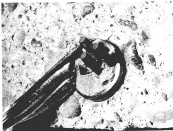
Rechte Bruchfläche Gerissene Drähte des Spanngliedes
