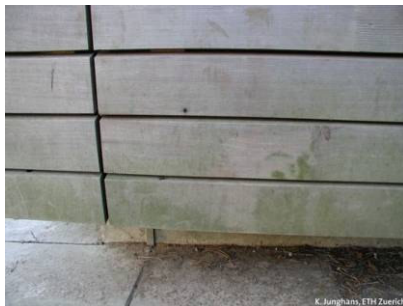
Abbildung 29 Besiedlung einer Holzfassade mit Algen (Spritzwasserbereich)
