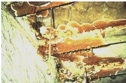
Abbildung 47 Fruchtkörper des E.H. an Deckenbalken
