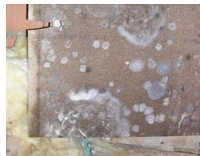
Abbildung 32 Schimmelpilze auf Spanplatte (Quelle: www.holzfragen.de )
