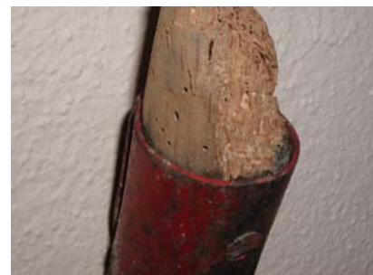
Abbildung 57 Schaden durch Nagekäfer an Geländerholm
