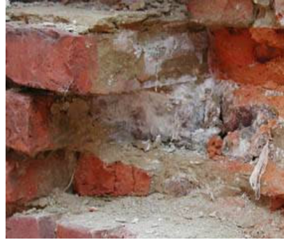
Abbildung 46 Vom E.H. durchwachsenes Mauerwerk (Quelle: www.holzfragen.de )
