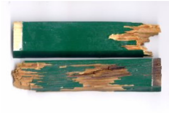
Abbildung 39 Schaden durch Blättlinge an Fensterholz
