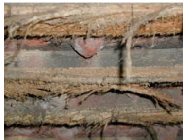
Abbildung 21 Mazeration (chemisch erwirkter Schaden) an Deckenbalken (Quelle: www.holzfragen.de )
