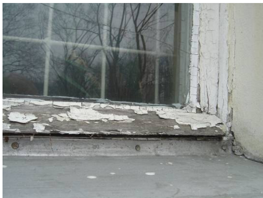
Abbildung 22 Abplatzen der Farbschicht an Fenster mangels Unterhalt
