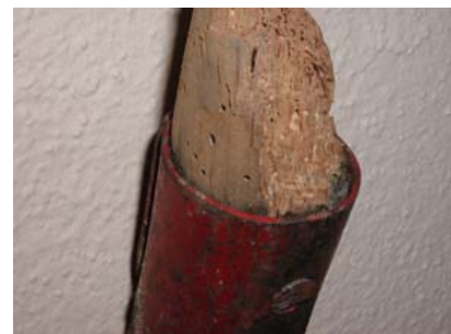
Abbildung 57 Schaden durch Nagekäfer an Geländerholm
