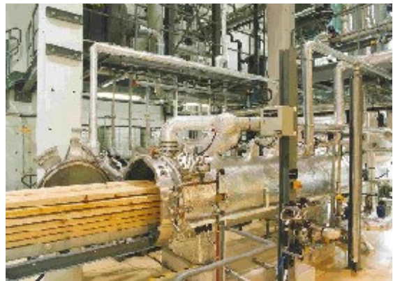
Abbildung 75 Acetylierungs-Anlage in der Industrie
