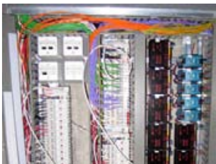
Wohnhaus in Zürich. Verteilschrank mit digitalen Steuerungskomponenten. Quelle: Autor.
