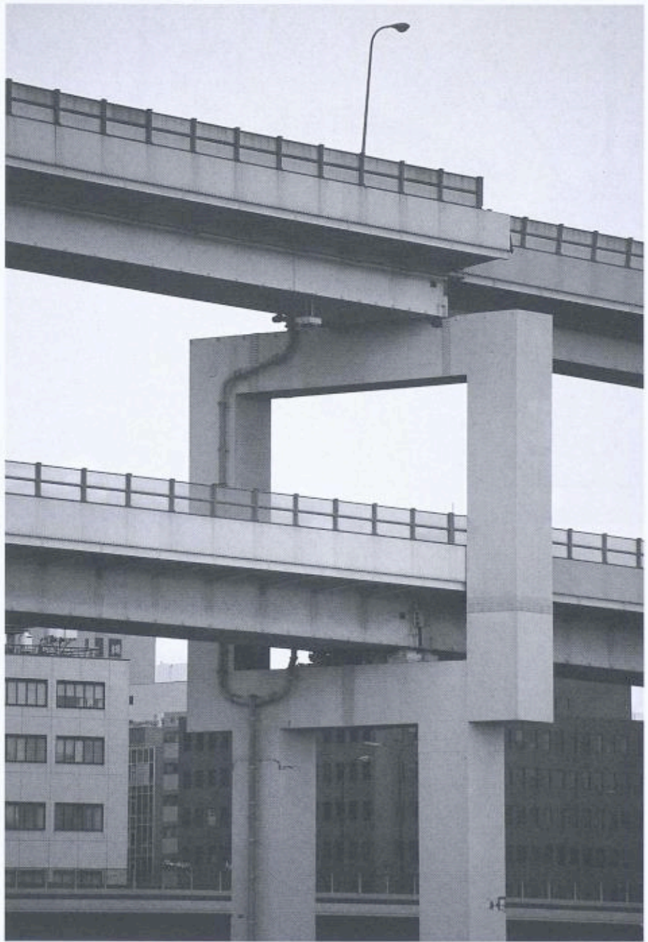
Bild 12. Beinahe-Absturz des oberen Brückenträgers
