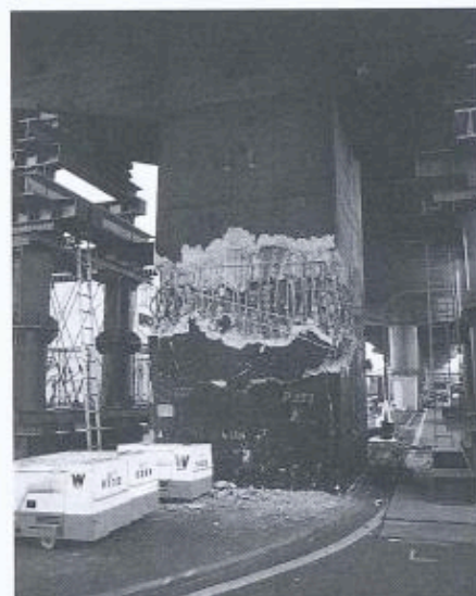
Bild 9. Bruchzone auf mittlerer Höhe einer Stütze des Hanshin-Expressways
