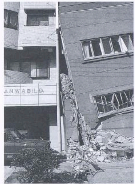
Bild 18. Eingestürztes älteres Gebäude lehnt sich an unbeschädigten Neubau
