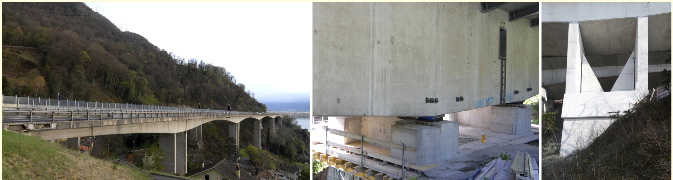
Bild 7. Erdbebenertüchtigung der Zwillingsviadukte von Chillon (links), seismische Isolation mit Blei-Gummilagern auf einer niedrigen Doppelstütze (Mitte), Stahlbeton-Ummantelung einer höheren Doppelstütze (rechts).
