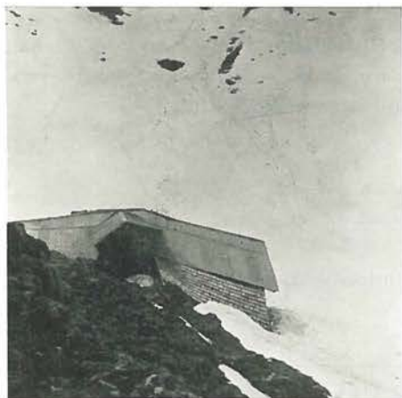
Fig. 42: Die durch eine Lawine von ihren Grundmauern geschobene Bühlhütte im Brisengebiet
