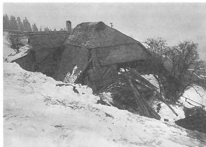
b) Detailaufnahme des stark beschädigten Gebäudes
